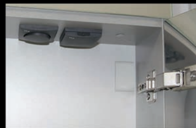
Detail umístění zásuvky a vypínače BERKER uvnitř R ZS a PIR ZS
